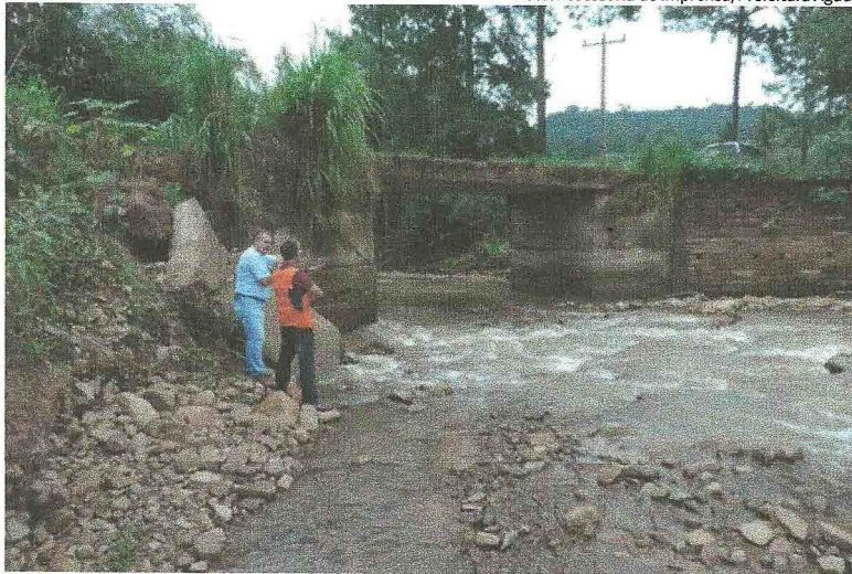
Defesa Civil percorre áreas atingidas pela chuva da última terça-feira em Agudo
